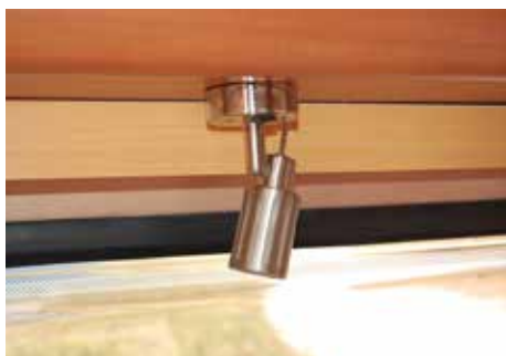
Interiérové bodové osvětlení.
