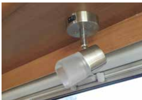
Interiérové bodové LED osvětlení.
